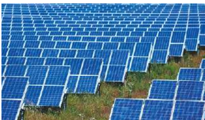
СОНЯЧНА ЕЛЕКТРОСТАНЦІЯ ООО «СОЛАР ЕНЕРЖІ-СКІФ» Вінниця 2019
