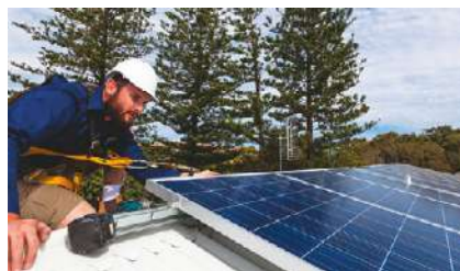
СОНЯЧНА ЕЛЕКТРОСТАНЦІЯ ООО «МИИА ГРУП» Дніпро 2019
