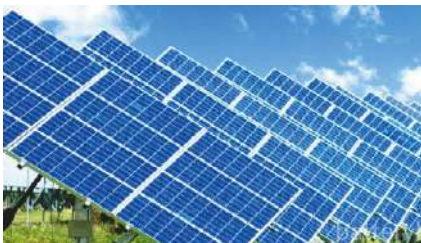
СОНЯЧНА ЕЛЕКТРОСТАНЦІЯ ТОВ «АСК Інжиніринг» Херсонська обл. 2019
